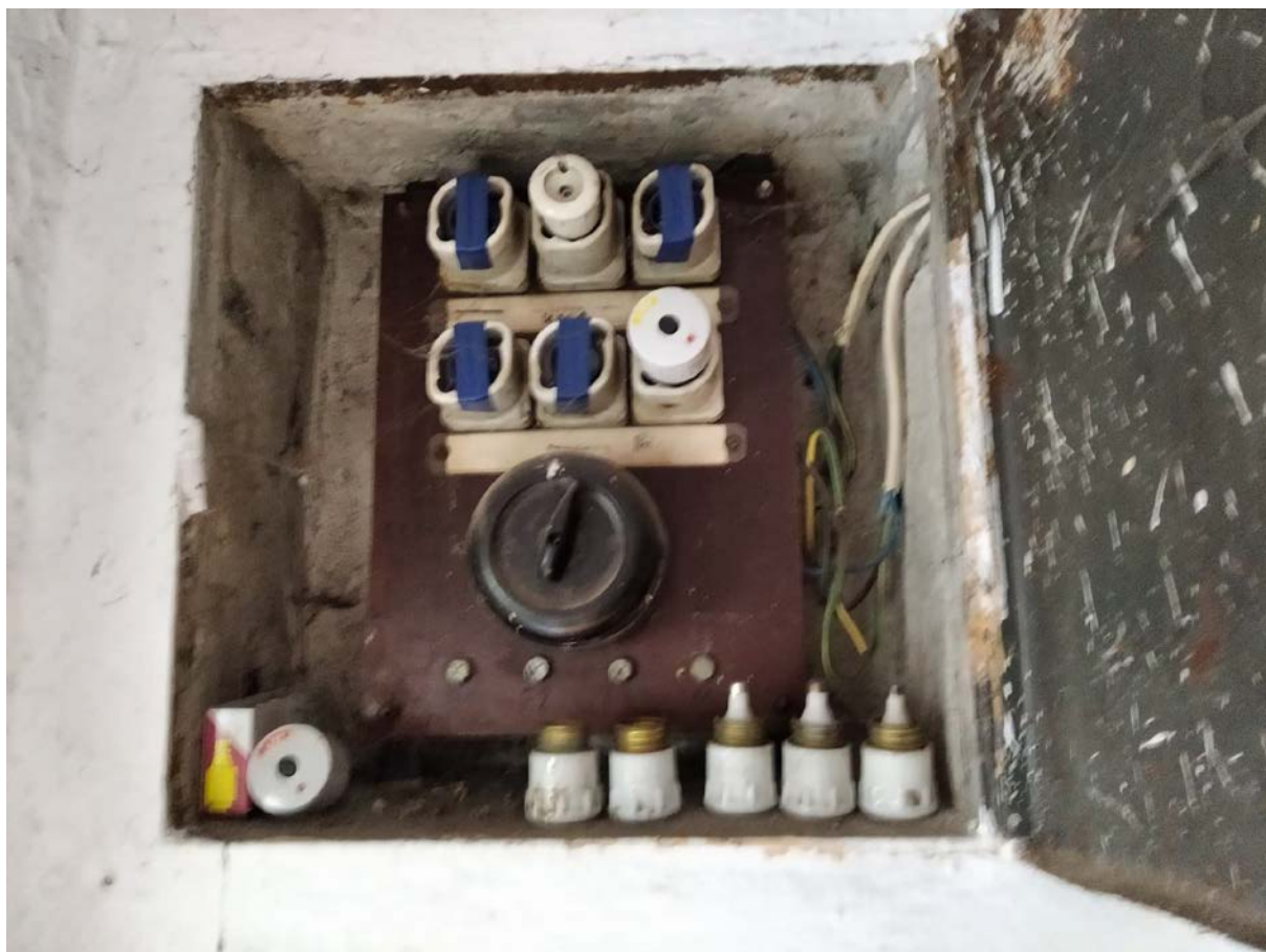
Zdjęcie: Pod widoczne śruby znajdujące się w dolnej części podpięty był prąd
