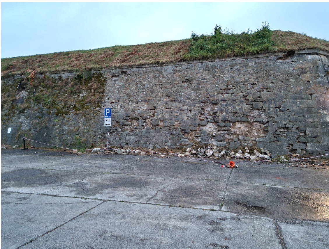
Zdjęcie: Bastion Ludmila. Część ściany się zwała. Tutaj ściana częściowo wyczyszczona z zieleni interwencyjnej i ze zrzucenymi luźnymi, zagrażającymi kamieniami
