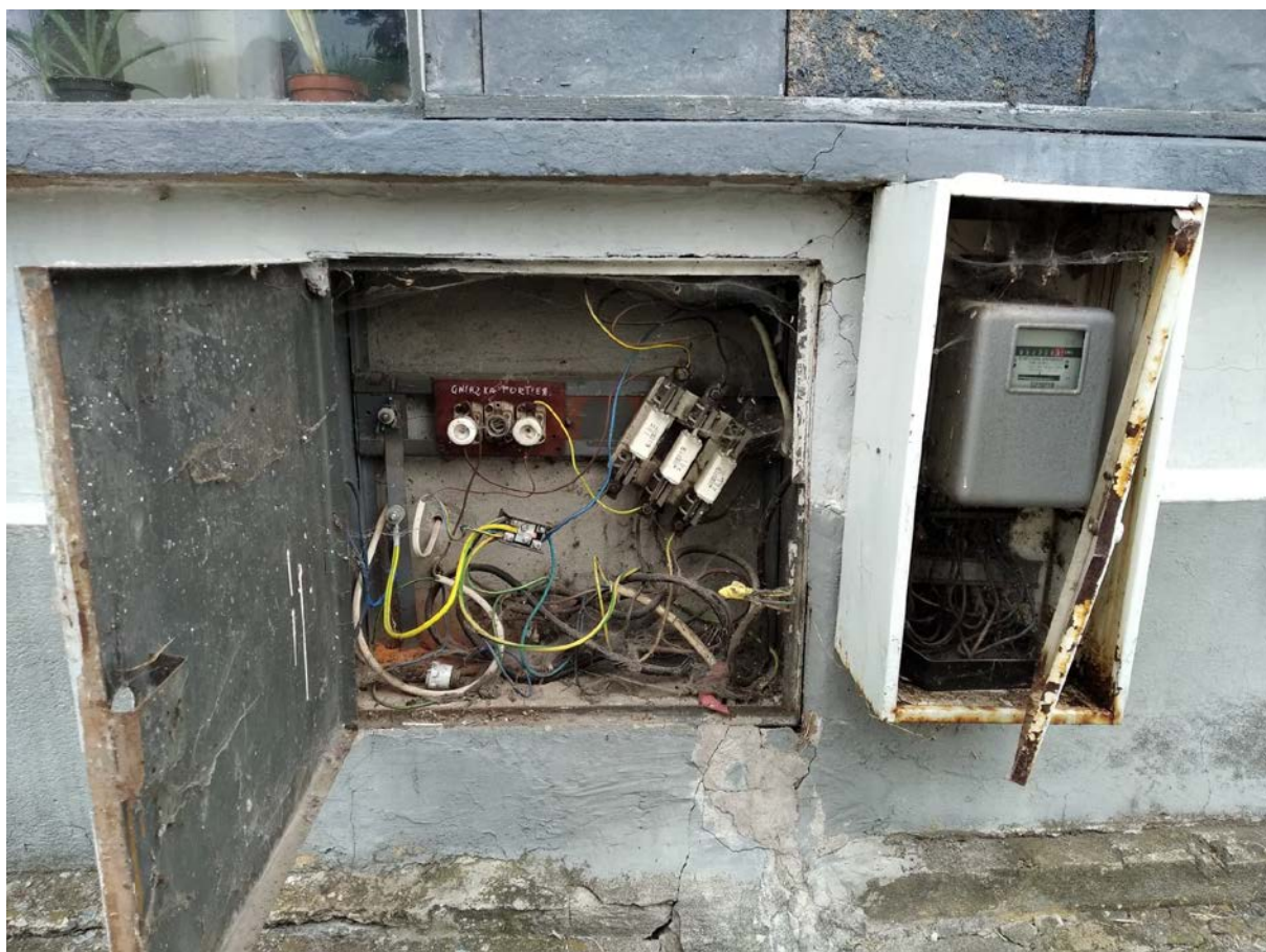
Zdjęcie: To nie jest pozostałość po starej instalacji. To była „działająca” skrzynka elektryczna
